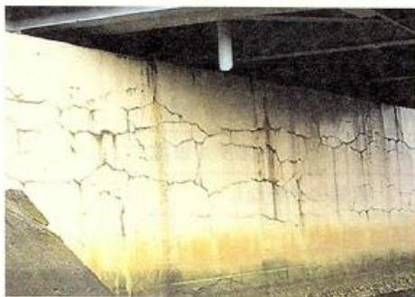
写真1 橋台のひび割れ
