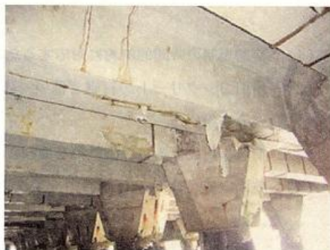
写真4 桁のひび割れ
