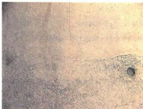
写真3 橋脚のコールドジョイント (縁切れない)
