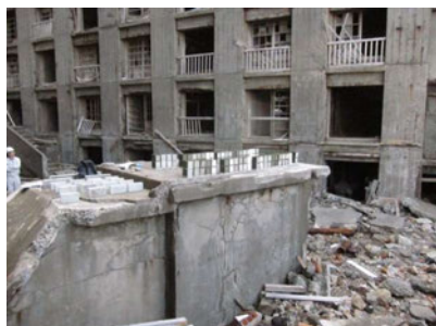
16号棟－59号棟間 (飛来塩分の多い環境)
