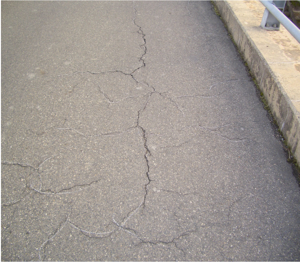
写真2 路面のひび割れ
