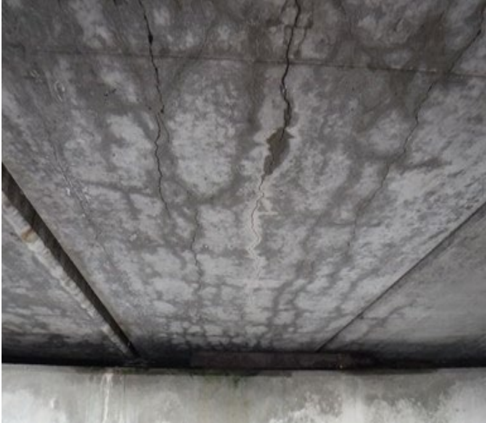
写真4 桁下面のひび割れ
