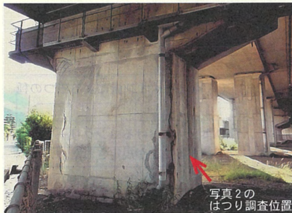
写真1 変状が生じた橋脚
