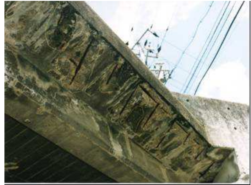
張出し床版下面の鉄筋露出
