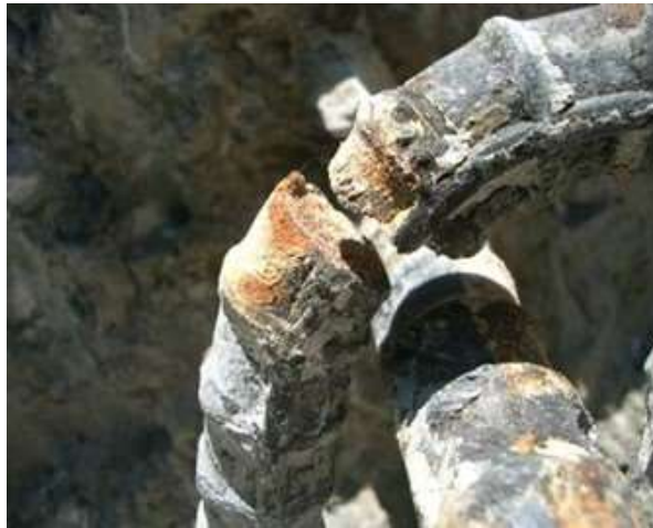
隅角部での鉄筋破断
