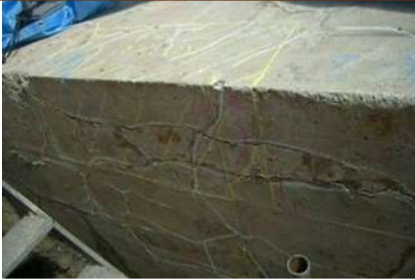
フーチングのひび割れ
