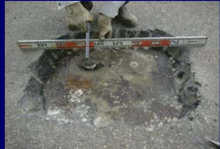
鉛直締めPC鋼棒の破断
