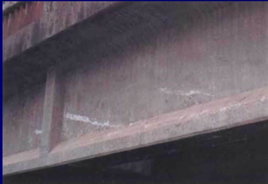
シースに沿ったひび割れ, エフロレッセンス
