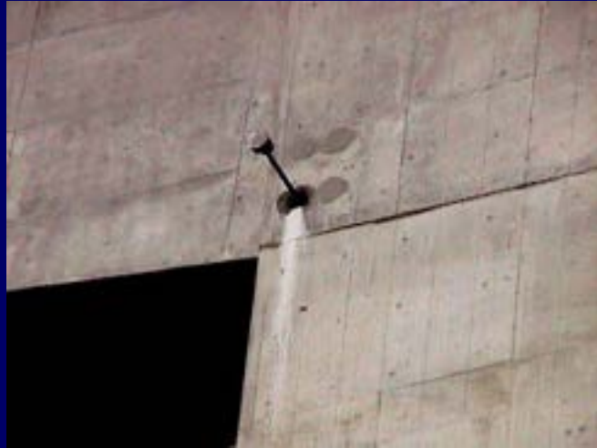
横締めPC鋼棒の破断
