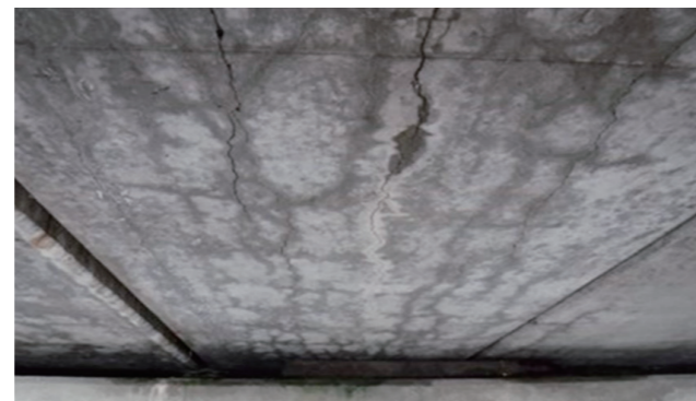
図-2 PC桁下面のひび割れ
