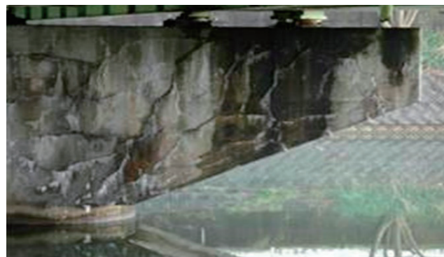
図-1 橋脚はり部のひび割れ
