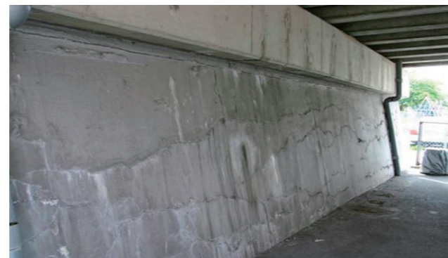
図-4 補修後の再劣化
