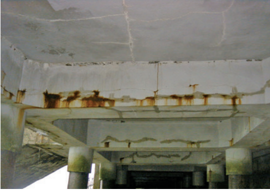
写真-1 塩害によるコンクリート構造物の劣化事例
