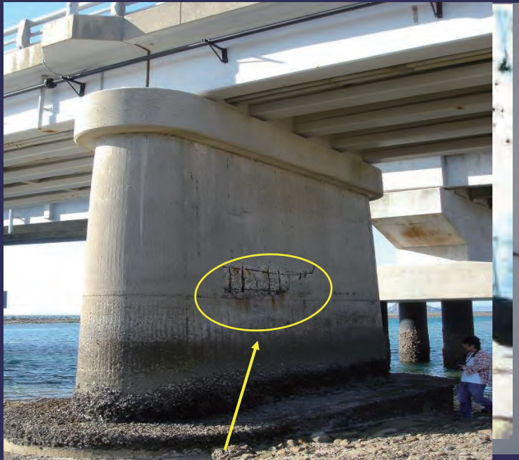
塩害（コンクリ塗料剥離）
