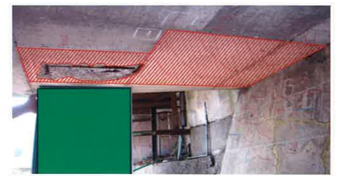
図-2 コンクリートの浮き、剥離
