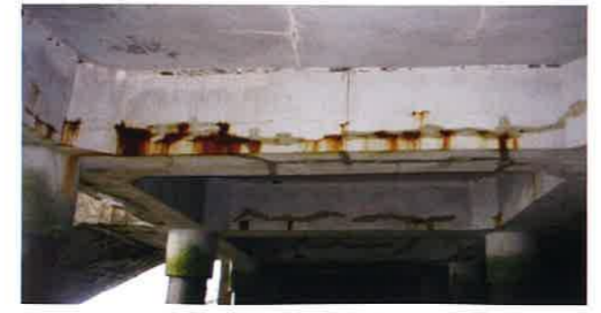
図-4 補修後の再劣化
