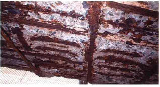
図-3 大規模な剥落と鉄筋露出
