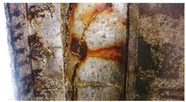
図-1 床版下面のひび割れ
