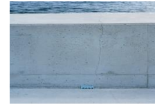
初期ひび割れ
