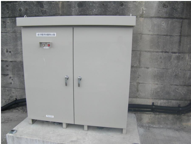
8回路用直流電源装置の例 基礎コンクリート上に設置。
