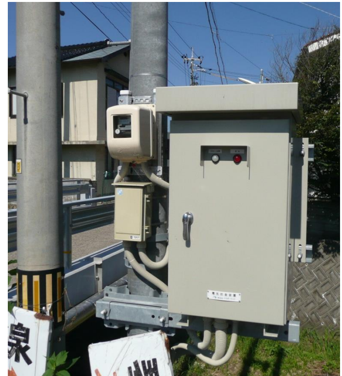
1回路用直流電源装置の例 コンクリート柱に設置。
