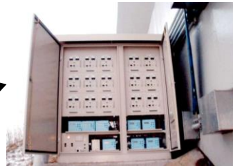
直流電源装置
