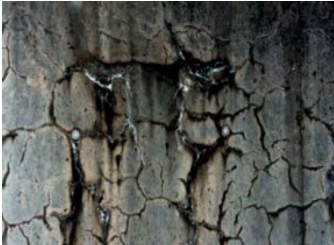
コンクリート表面の変状
