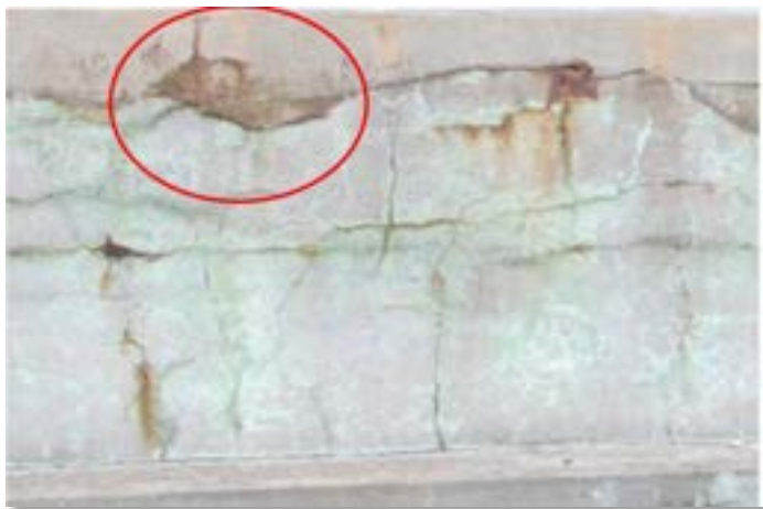
ひび割れの発生・さび汁
