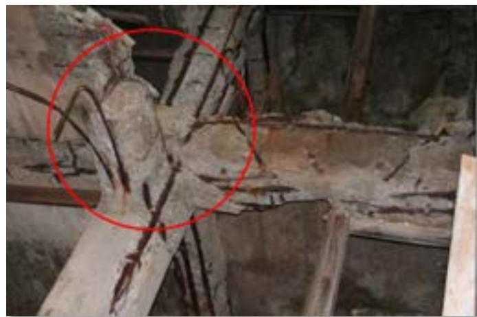
鉄筋の切断・消滅
