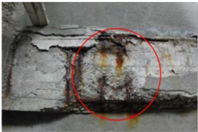
腐食の進行・断面積の減少
