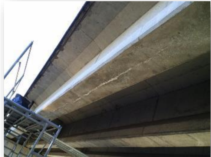
ポストテンション方式T桁の下フランジに生じたひび割れの事例
