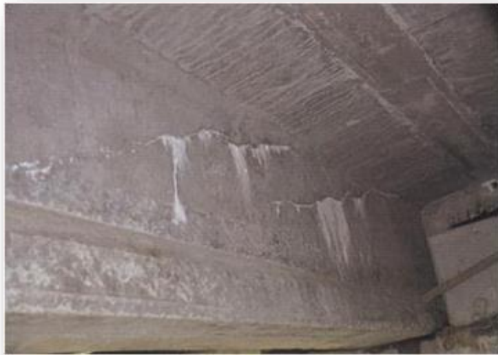
グラウト充填不良により生じたPC鋼材に沿ったひび割れとエフロレッセンス
