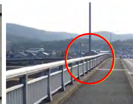
▲中央ヒンジ部の垂れ下がり41
