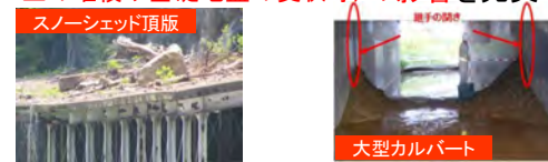
▲崩土等の堆積
