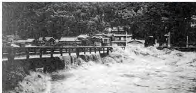
桁下高不足による支障事例
