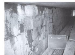
写真1 ASRによる橋台の劣化状況
