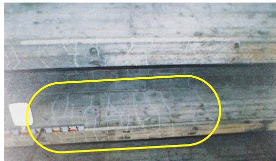
②支間中央部のひび割れ
