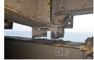
シェッド頂部の主梁端部 (破断の例)
