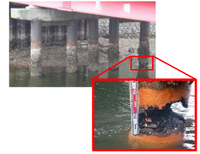
杭の水中部 (腐食・断面欠損の例)
