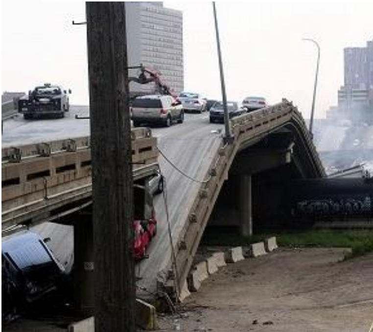
(I-35W) 鋼トラス橋崩壊の状況
