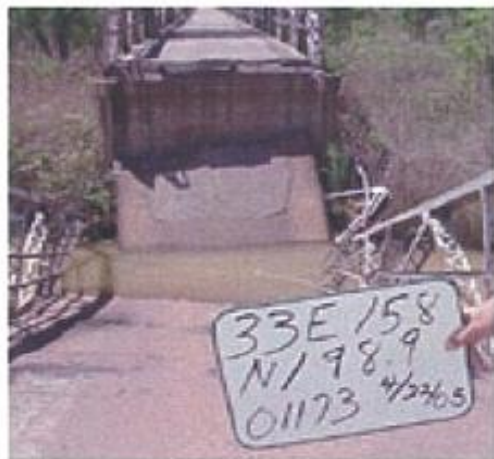
2005.4 ▲オクラホマ州無名橋 重車両による落橋
