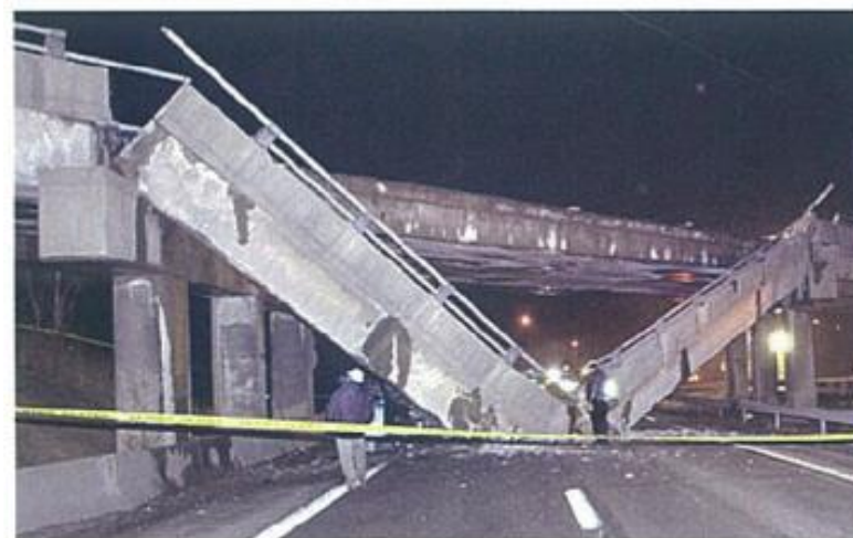
2005.12 ▲ペンシルベニア州 跨道橋の落橋 …凍結防止剤の散布による鉄筋腐食
