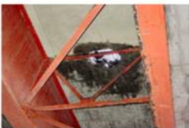
（橋梁の抜け落ち）
