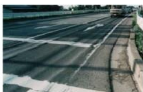
（舗装のわだち掘れ）
