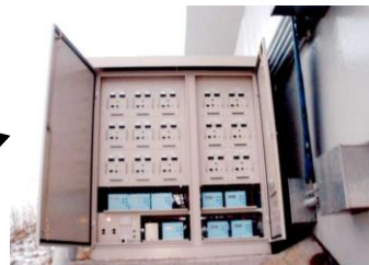
直流電源装置
