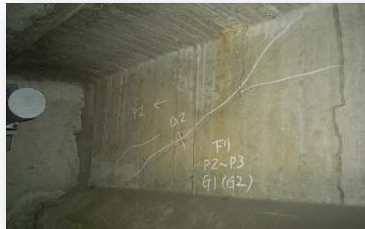
せん断ひび割れが生じたPCT桁
