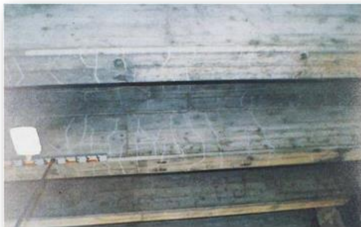
過大な荷重载荷により生じた曲げひび割れ
