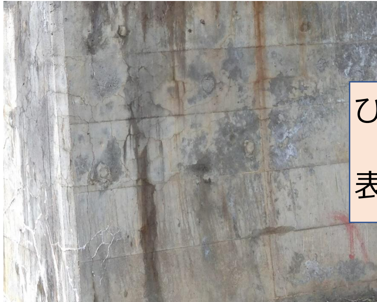
【補修前の劣化状況（2014年）】
