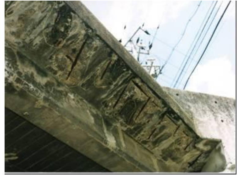
張出し床版下面の鉄筋露出
