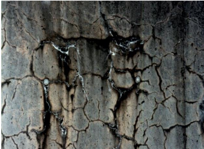
コンクリート表面の変状
