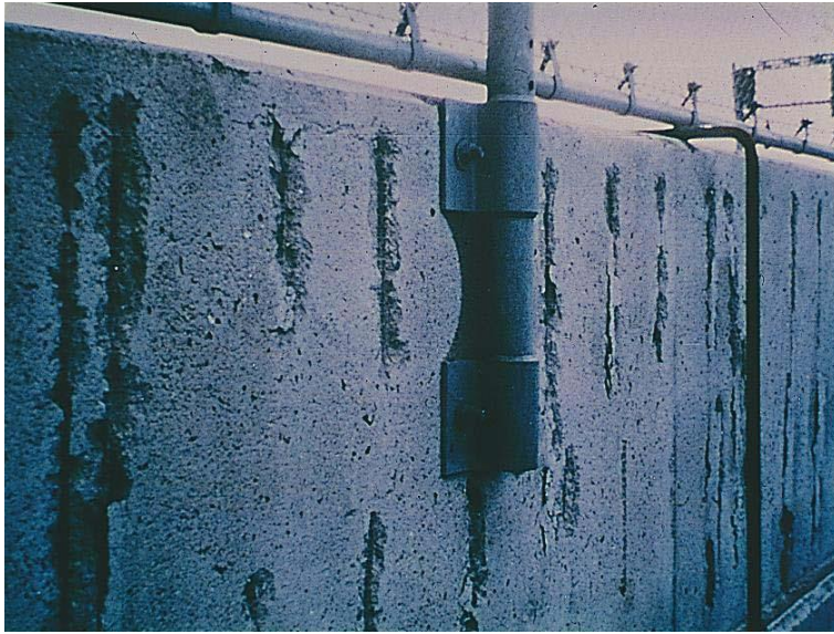
壁高欄のコンクリートはく落
