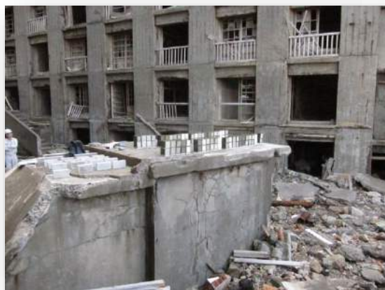
16号棟—59号棟間 (飛来塩分の多い環境)
