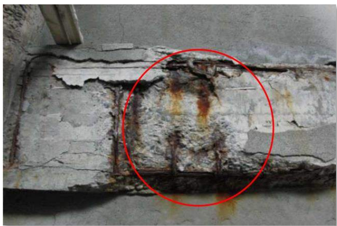
腐食の進行・断面積の減少
