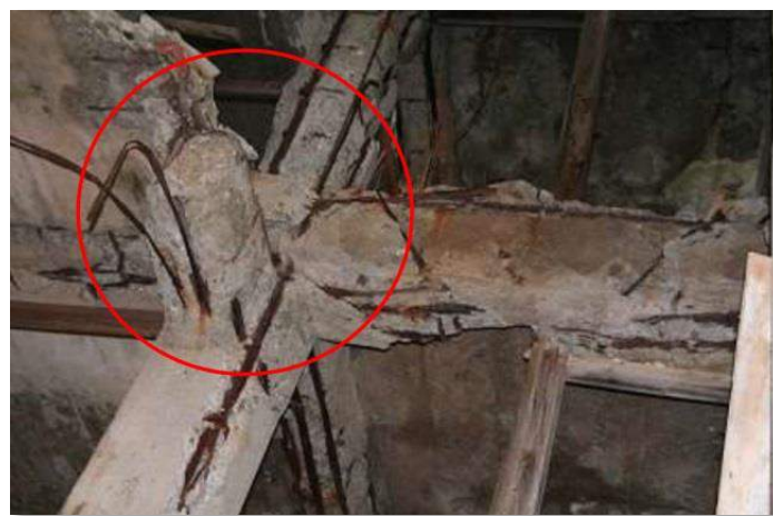
鉄筋の切断・消滅
