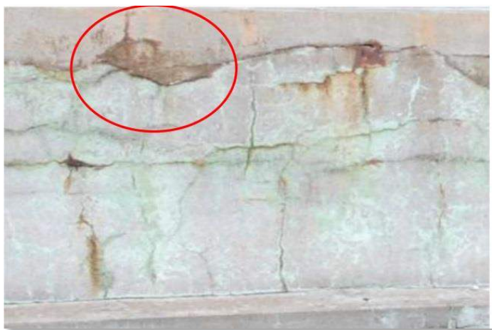
ひび割れの発生・さび汁
