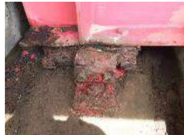
地方自治体管理 支承腐食
