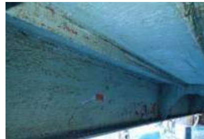
桁の塗装劣化やさびの発生
