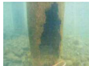
▲橋脚水中部の断面欠損
