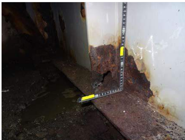
国管理 主桁腐食・欠損
