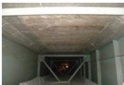
ひび割れの発生
