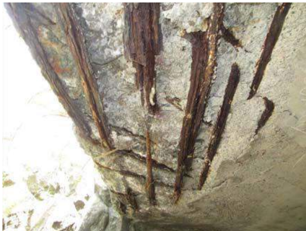
国管理 床版鉄筋露出 ※床版: 橋の裏側
