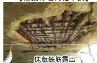
床版鉄筋露出
