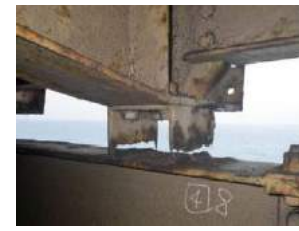
▲シェッド主梁端部破断
