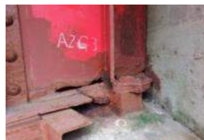
桁端部の腐食・貫通
