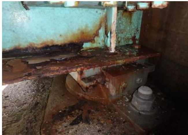
地方自治体管理 主桁腐食
