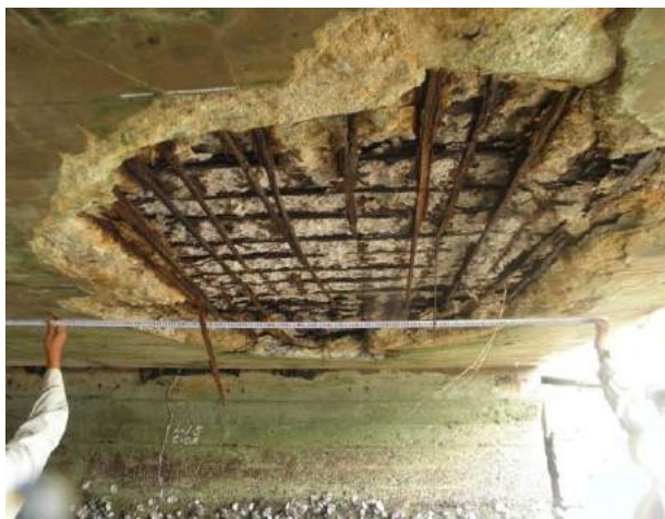
地方自治体管理 床版鉄筋露出
