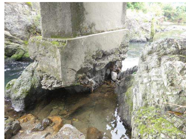
地方自治体管理 橋脚洗掘
