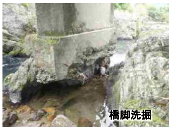
判定区分Ⅳ(緊急に措置を講ずべき状態)
