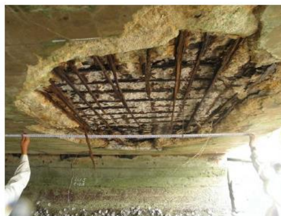
地方自治体管理 床版鉄筋露出
