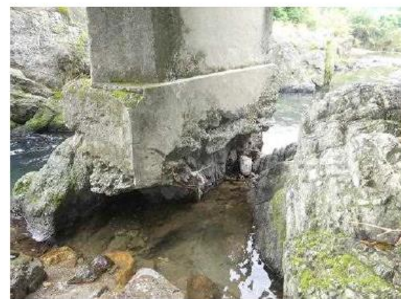
地方自治体管理 橋脚洗掘
