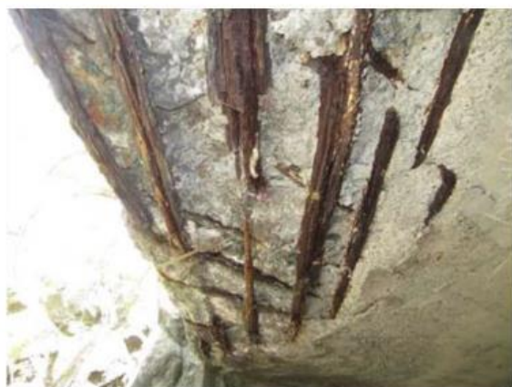
国管理 床版鉄筋露出
