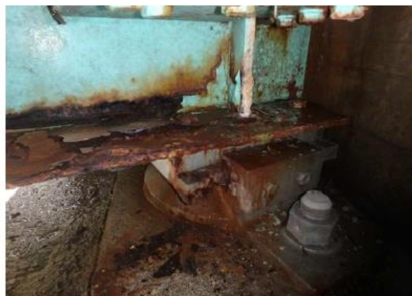
地方自治体管理 主桁腐食
