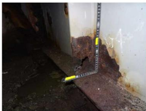
国管理 主桁腐食・欠損
