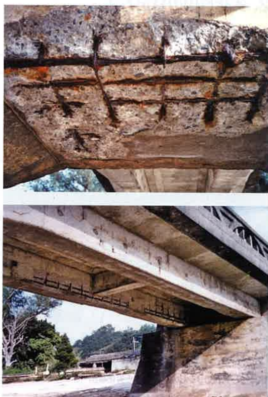
写真-1 塩化物イオンによる劣化（塩害）の事例
