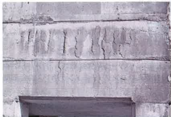
写真-2 中性化による鉄筋腐食の事例
