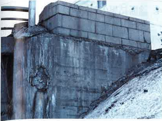
写真-4 凍害を受けたコンクリート構造物
