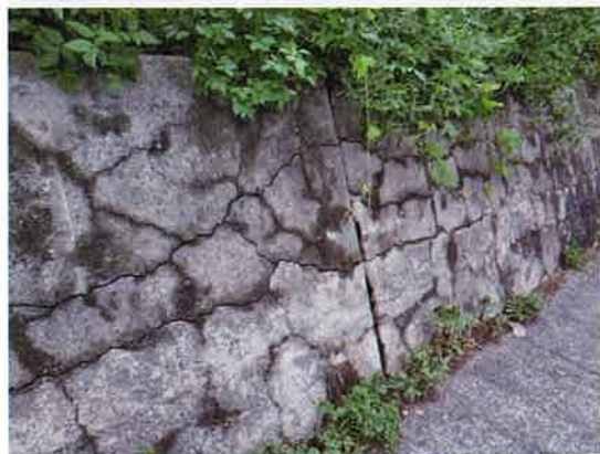
写真-3 アルカリシリカ反応による劣化事例
