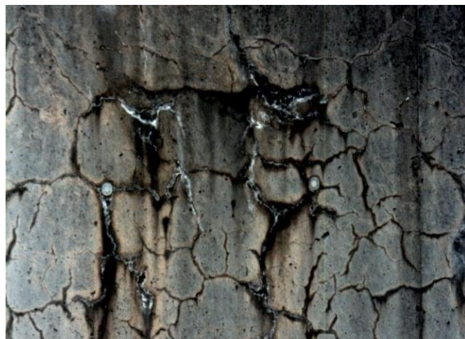
コンクリート表面の変状
