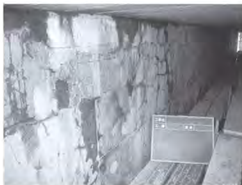
写真1 ASRによる橋台の劣化状況
