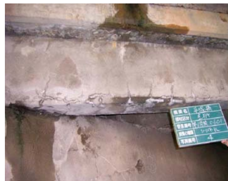
主桁の損傷状況
