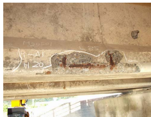
損傷: PC主桁の剥離・鉄筋露出(塩害※)
