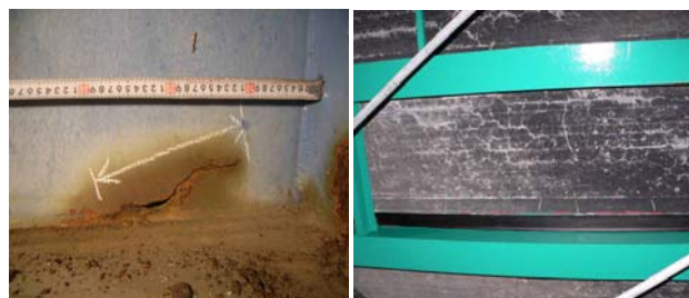
桁の亀裂(左)、床版のひびわれ(右)
