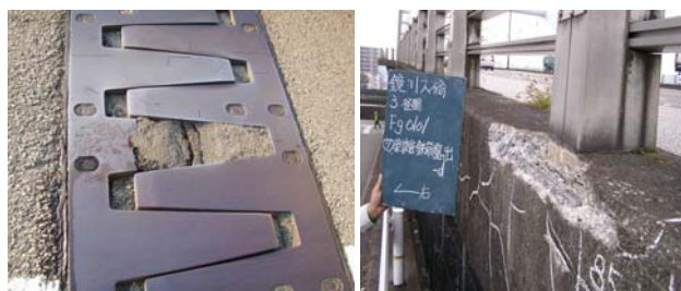
路面の伸縮装置の欠損(左)、コンクリートの剥落(右)
