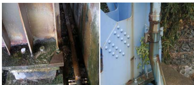
桁端の滞水(左)、排水管の詰まり(右)
