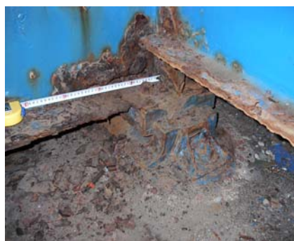
① 事後保全(要対策)の損傷 対策:部材の当て板補修・支承取替
