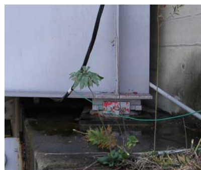
③ 予防保全(要対策)の損傷 対策:部分塗替え・漏水対策
