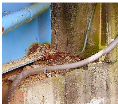
② 移行期(要対策-C判定) 対策:部分塗替え・清掃
