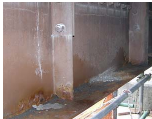
損傷: 鋼主桁の腐食
