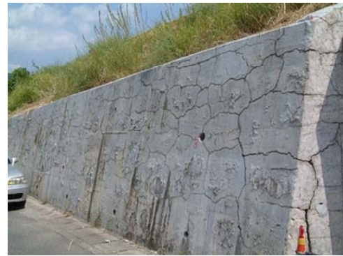
図－１ 構造物の劣化状況
