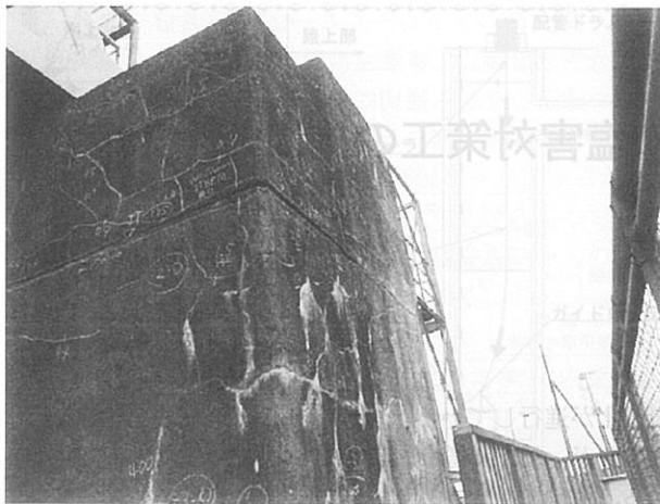
写真-2 取水橋台劣化状態
