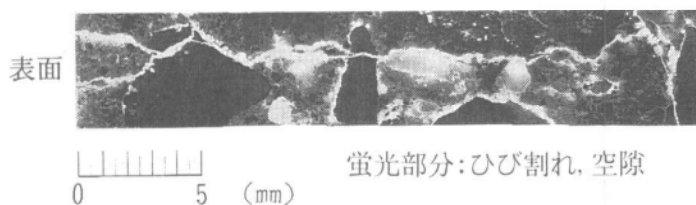
写真-2 蛍光顕微鏡によるコンクリートコアのASRひび割れの観察結果(PC-4)
