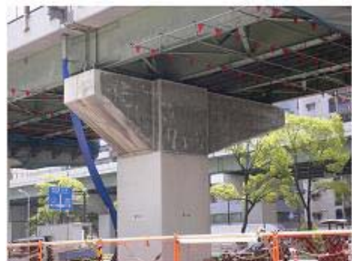
写真-1 ASR損傷RC橋脚（東下P41）
