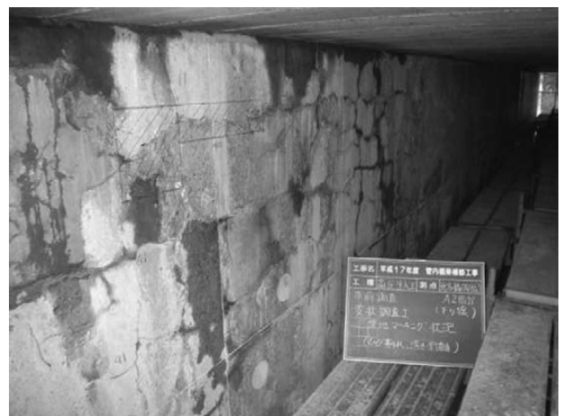
図2 ひび割れ発生状況
