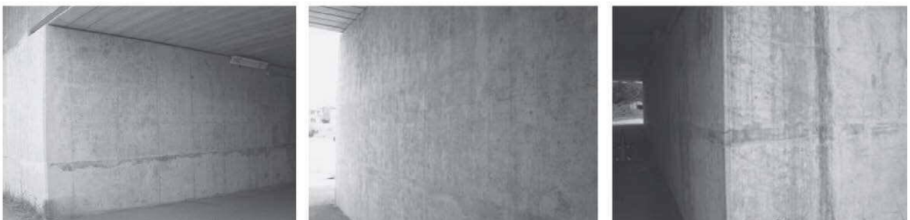
図17 施工前状況と施工後6年経過時の外観状況
