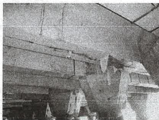
写真4 桁のひび割れ
