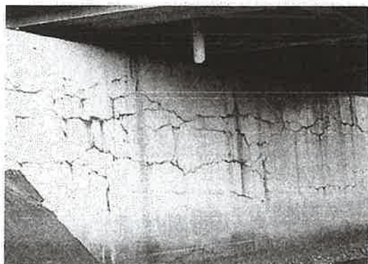
写真1 橋台のひび割れ
