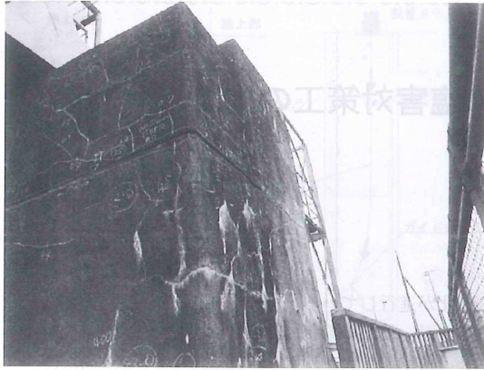
写真一2 取水管橋台劣化状態
