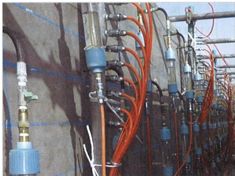
リハビリカプセル工法による港湾構造物のASR・塩害補修状況
