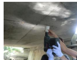
コンクリート粉末の採取状況
