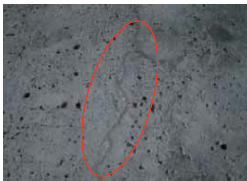
図-5 ひび割れ注入跡の状況
