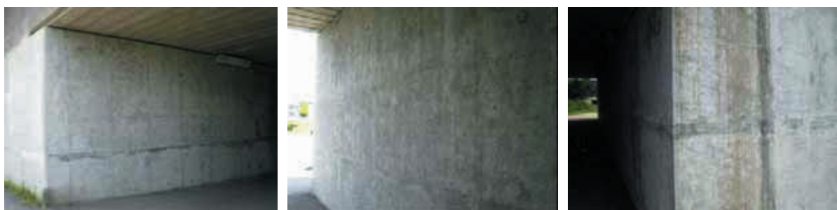
図-4 S 橋橋台 施工前状況と施工後 4 年経過時の状況
