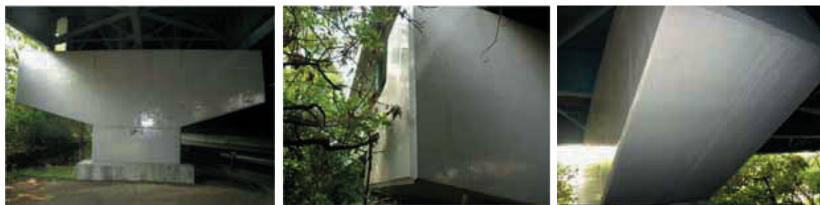
図-3 K 高架橋橋脚 施工前状況と施工後 5 年経過時の状況
