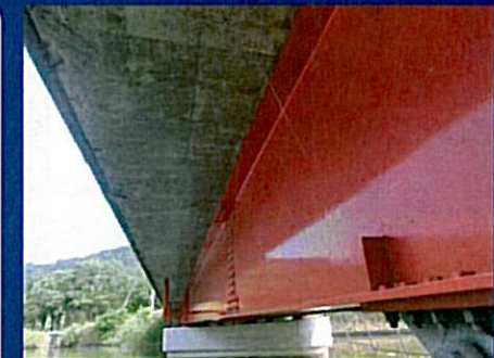
①着工前(劣化状況)
