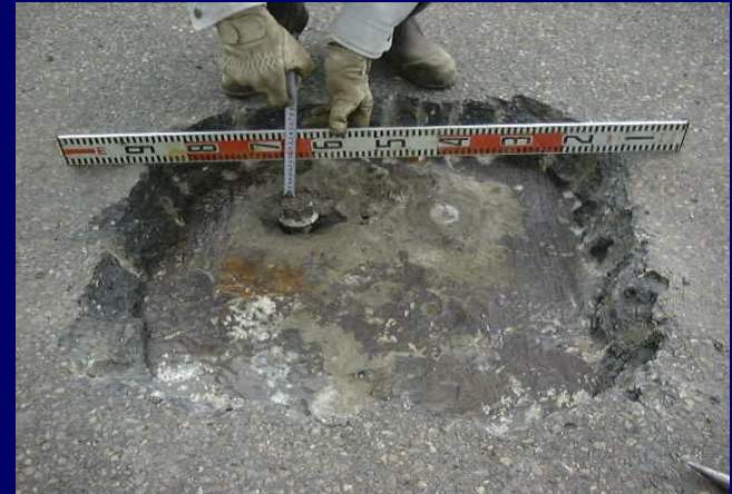
鉛直締めPC鋼棒の破断
