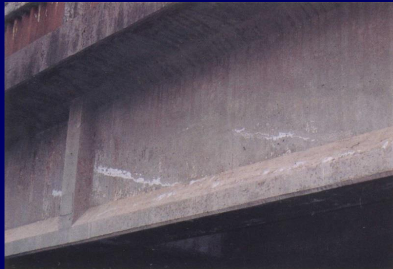
シースに沿ったひび割れ，エフロレッセンス
