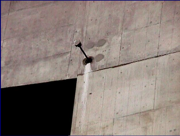
横締めPC鋼棒の破断
