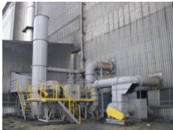
屋外排気設備 施工3年後
