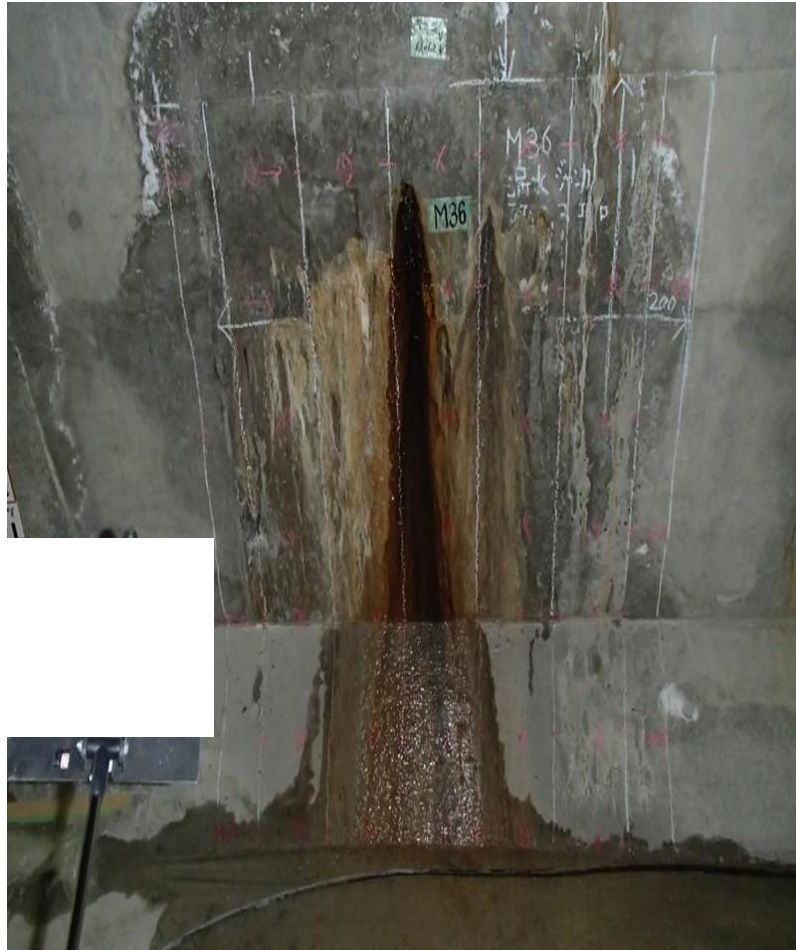
施工前：漏水状況
