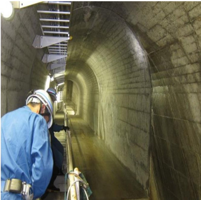
施工前：漏水状況
