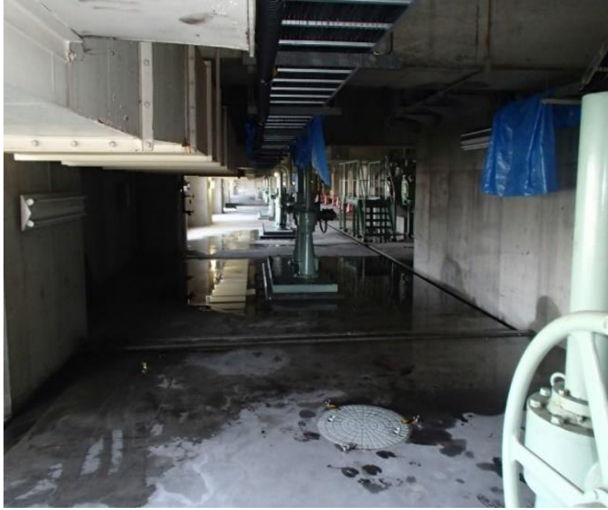
施工前：漏水状況
