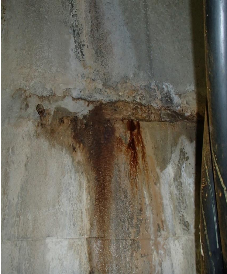
施工前：漏水状況
