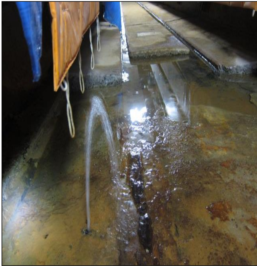
電力洞道漏水状況 都市N A T M
