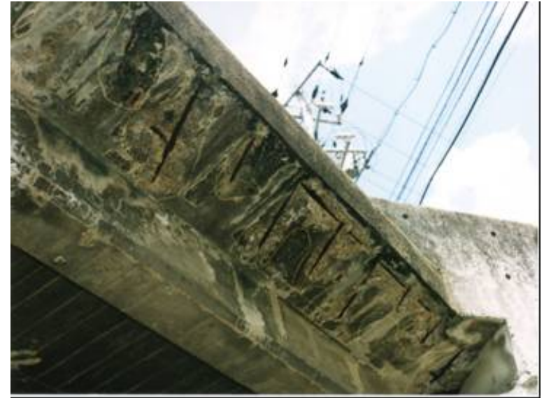
張出し床版下面の鉄筋露出
