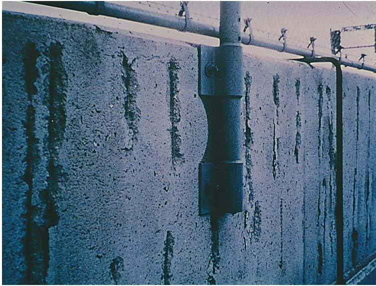
壁高欄のコンクリートはく落
