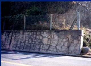
擁壁のASR劣化
