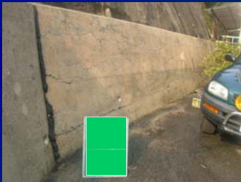
①着工前(劣化状況)
