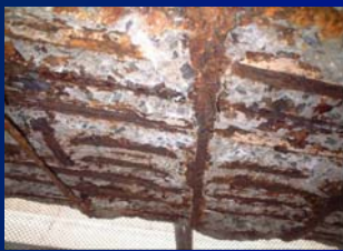
主桁下面の鉄筋腐食
