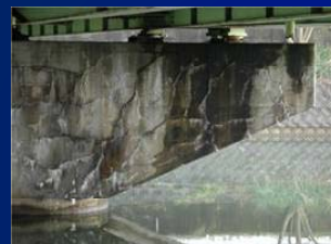
橋脚のASR劣化
