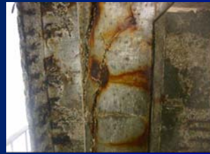
床版下面の錆汁
