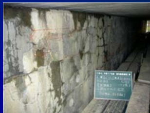
橋台のASR劣化
