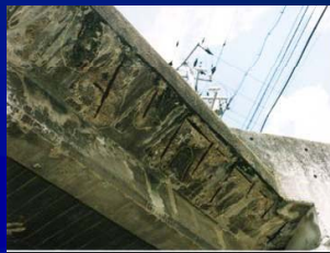
張出し床版下面の鉄筋露出
