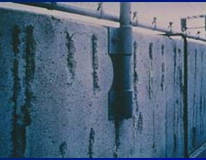
壁高欄のコンクリートはく落
