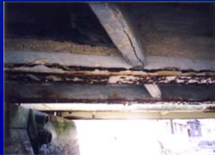
補修箇所の再劣化
