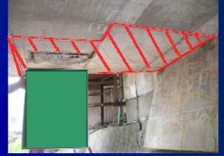
コンクリートのはく離・はく落
