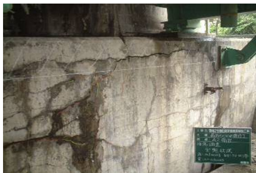
図-1 対象構造物の外観変状の例
