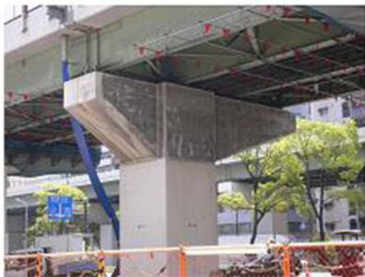
図-1 試験に用いた ASR 損傷 RC 橋脚
