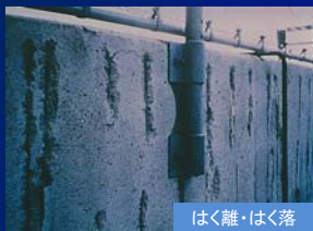
はく離・はく落
