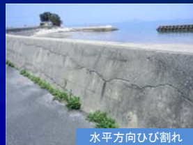
水平方向ひび割れ
