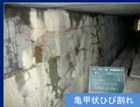
亀甲状ひび割れ
