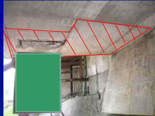
①着工前(劣化状況)
