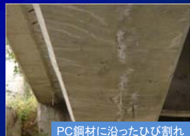
PC鋼材に沿ったひび割れ
