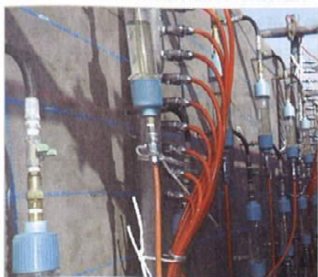
リハビリカプセル工法による港湾構造物のASR・塩害補修状況
